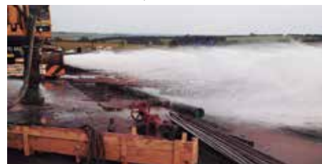
Poço profundo garante abastecimento de água para uma cidade inteira.
